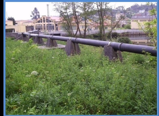
Tubería de fundición abastecimiento
